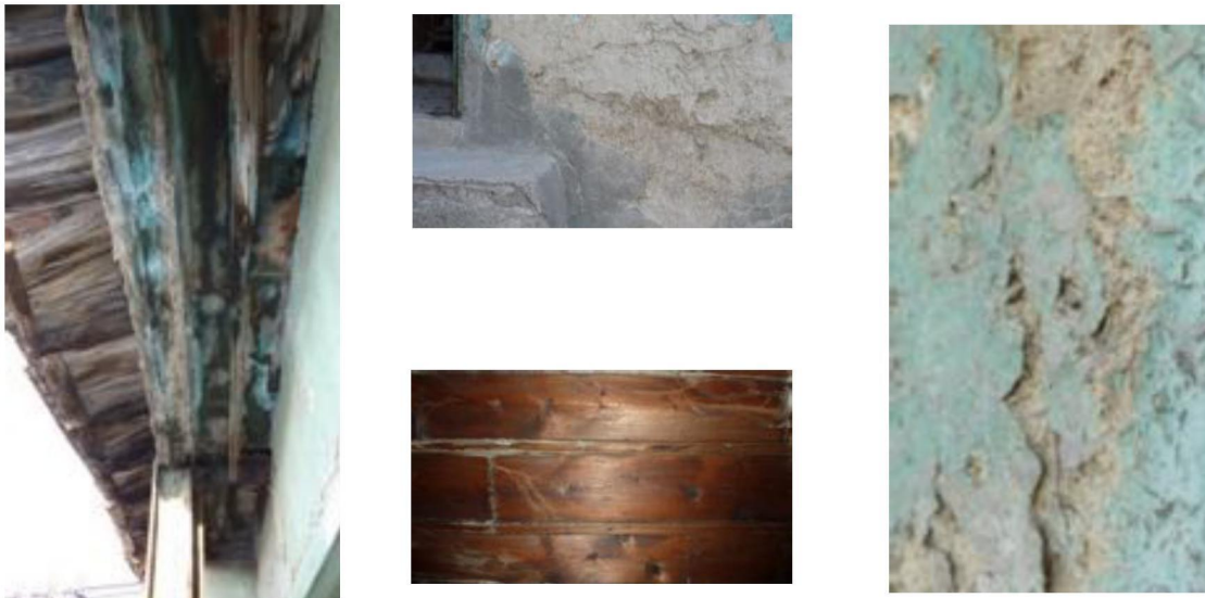
Şekil 14. Yapıda farklı malzeme sorunları
