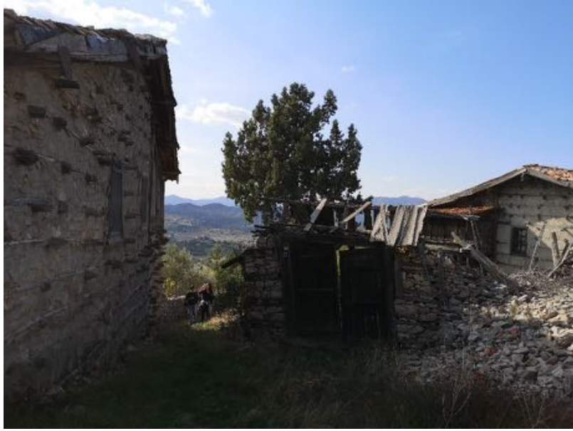
Şekil 6. Belenalan Köyü'nde kullanım dışında kalarak yıkılmaya başlamış geleneksel yapı örneği (2018)
