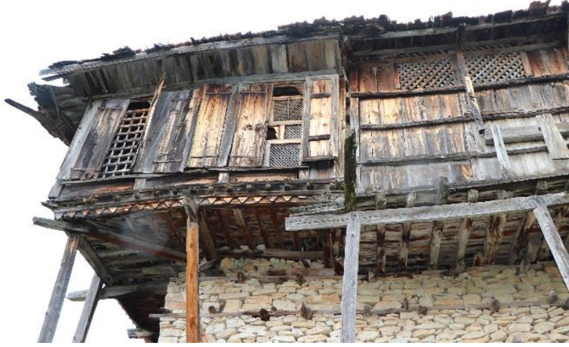
Resim 19/ Photo 19: Batı cephedeki çıkmanın ahşap taşıyıcı sistemi ve bozulmalar / The wooden construction and deteriorations on the projection in the west elevation (Kuleli, Akdeğirmen, 2019).
