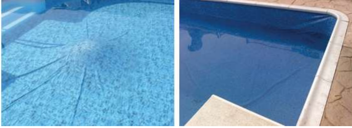
Şekil 4. PVC Kaplamasında Aşırı Yağışlar Sonucu Meydana Gelen Şişme ve Kırışıklık (Robert, 2018)
